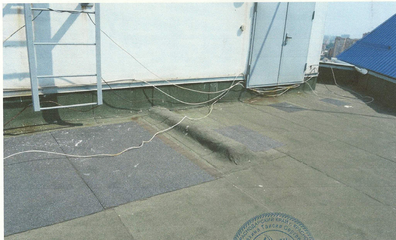
Фото №9-10. Участки, имеющие вздутие водоизоляционного ковра
